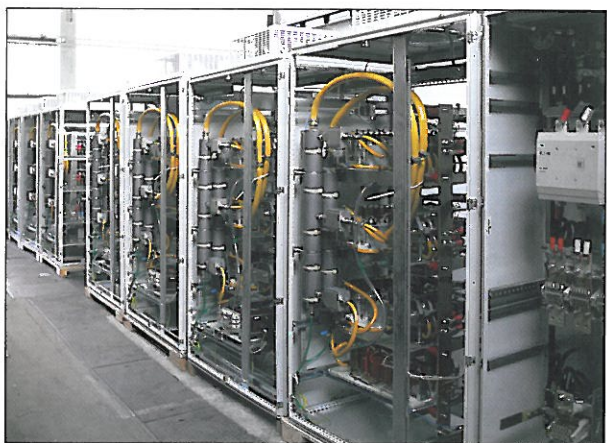
10. ábra A ciklokonverteres hajtás mérése a VHJ Kft. laboratóriumában
