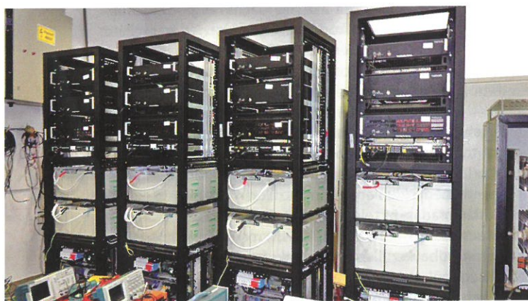
9. ábra 4 db 10kVA-es, FTUPQ típusú szünetmentes áramellátó rendszer
